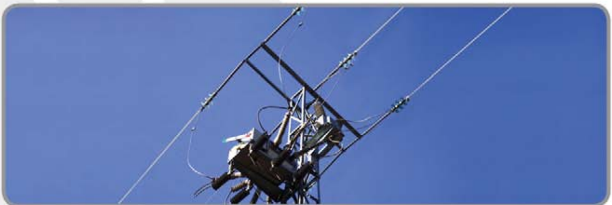
Centro Transformación Aéreo
